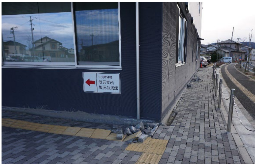
液状化_建物基礎被害①
