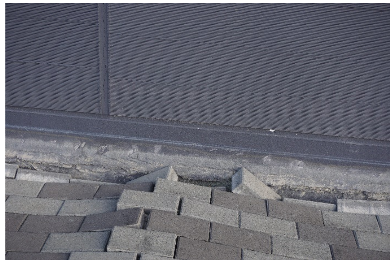
液状化_建物基礎被害②
