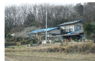
20210217_山元町家屋被害
