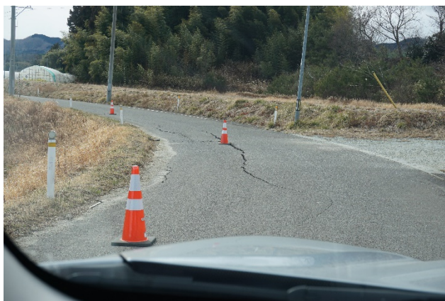
道路の地割れ③（山元町宮城病院周辺）
