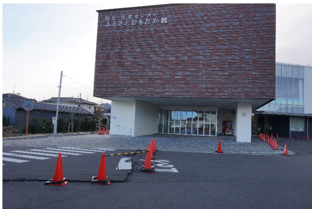
道路の地割れ①
