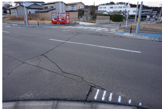
道路の地割れ②
