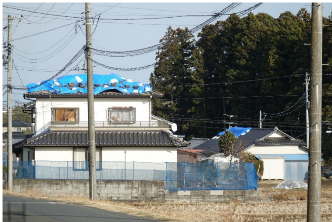
建物被害（福島県新地町）
