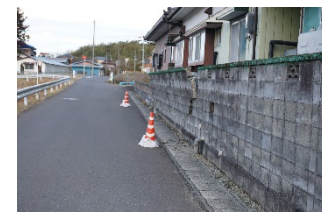
20210217_山元町家屋被害
