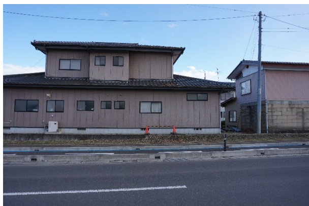
屋根瓦の崩落
