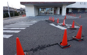
20210217_山元町道路被害
