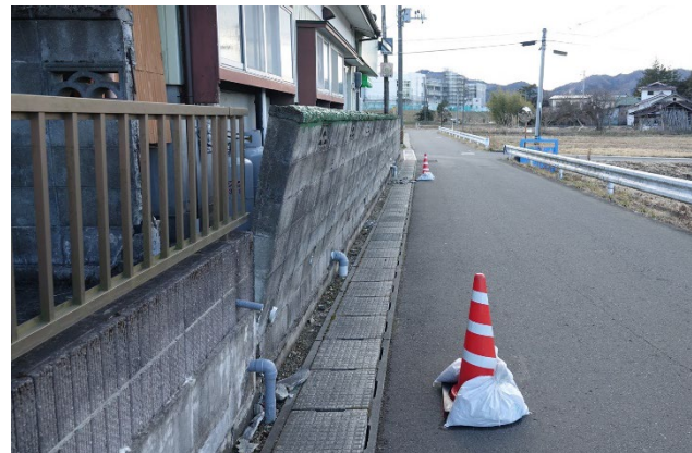
ブロック塀の破損
