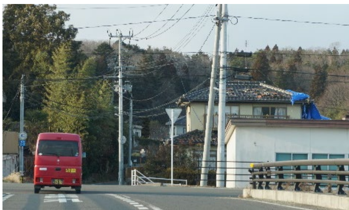
建物被害（福島県新地町）
