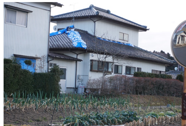
屋根瓦の崩落箇所（ブルーシート部分）
