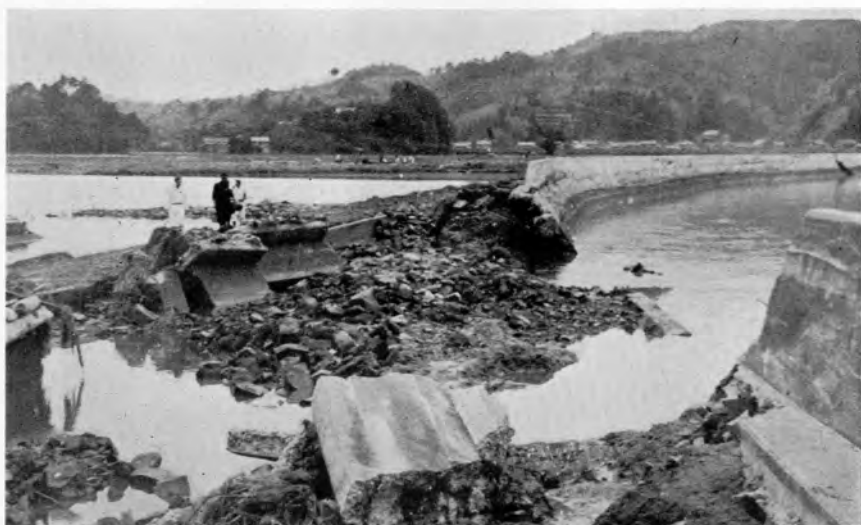
写真15 徳島県福 井川大原堤防被 災状況
