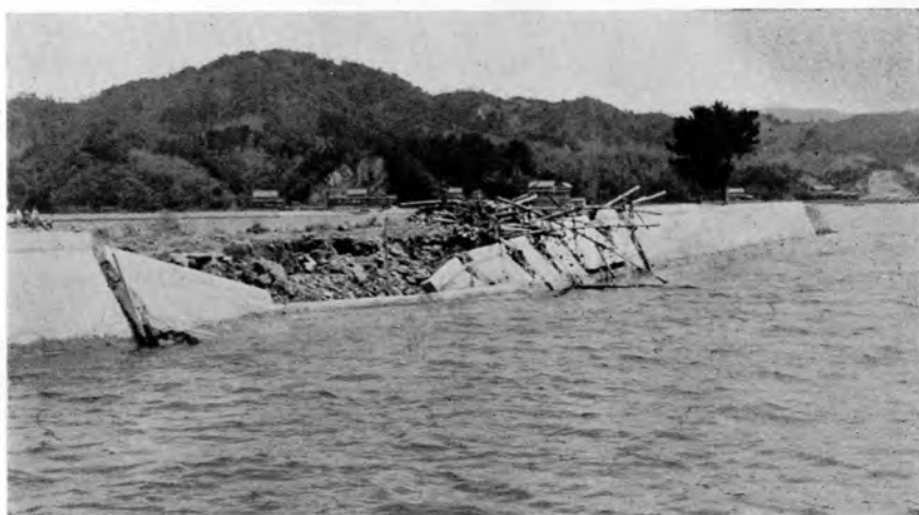
写真16 徳島県橋町南 新田突角部の被災状 況 護岸上の竹は真 珠養殖の筏
